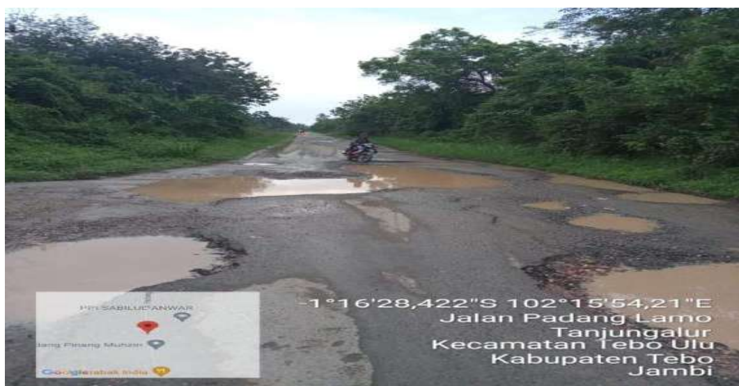
Gambar 4.1 Kondisi Jalan di Kecamatan Tebo Ulu
